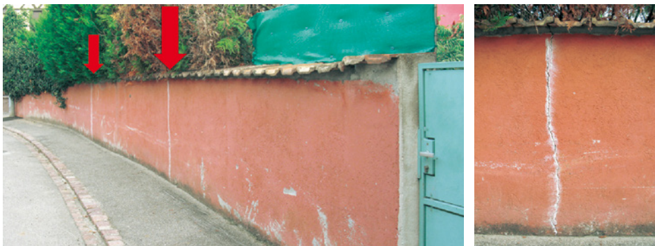
Bild 2.1 Lange, fugenlose gemauerte Wand mit zwei Vertikalrissen (Pfeile)
