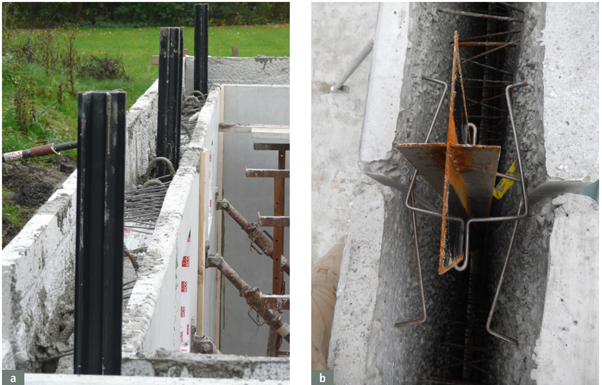
Bild 2.11: Ausbildung der Stoßfugen von Elementwänden als Sollrissquerschnitt mit Dichtrohren (a) bzw. Sollrissfugenschienen (b)
