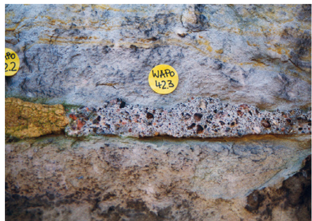
Abb. 3 Der Mörtel WPAO42.3 befindet sich direkt neben dem braunen Mörtel und enthält sehr grobe Gesteinskörnungen.
