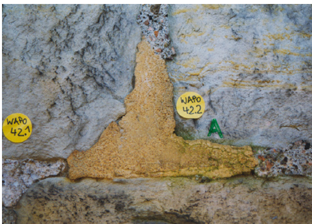
Abb. 2 Der Mörtel WPAO42.1 ist ein Gipsmörtel und der braune Mörtel enthält Romanzement als Bindemittel.
