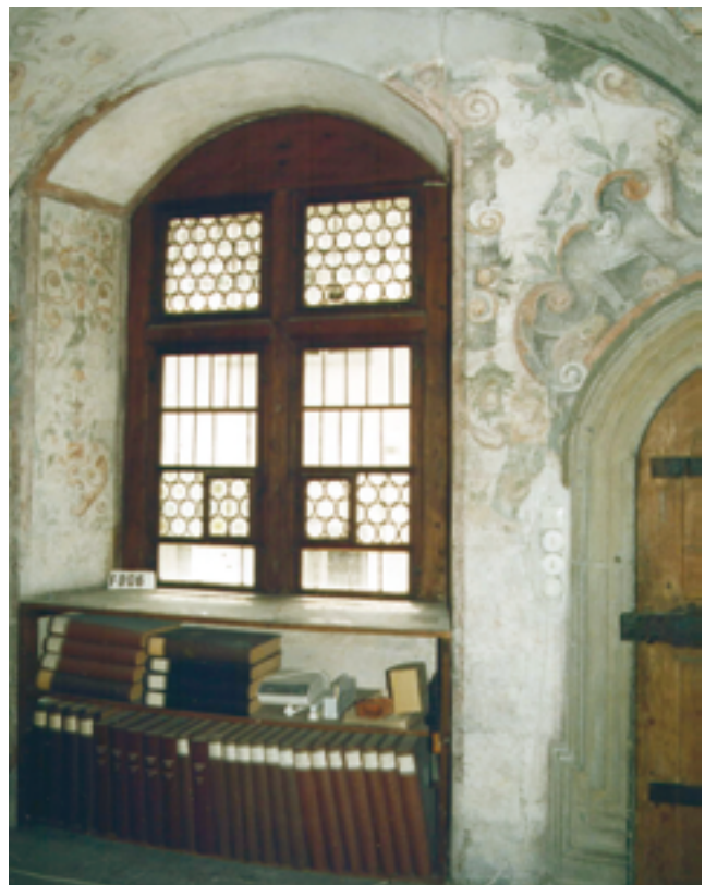
Abb. 1.25: Überlingen, Münsterplatz 8, Stadtkanzlei, erbaut 1598 bis 1600: Die bauzeitliche Rundscheibenverglasung ist nur noch in Teilbereichen vorhanden. Reparaturverglasungen wurden als Rechteckverglasungen ausgeführt.
