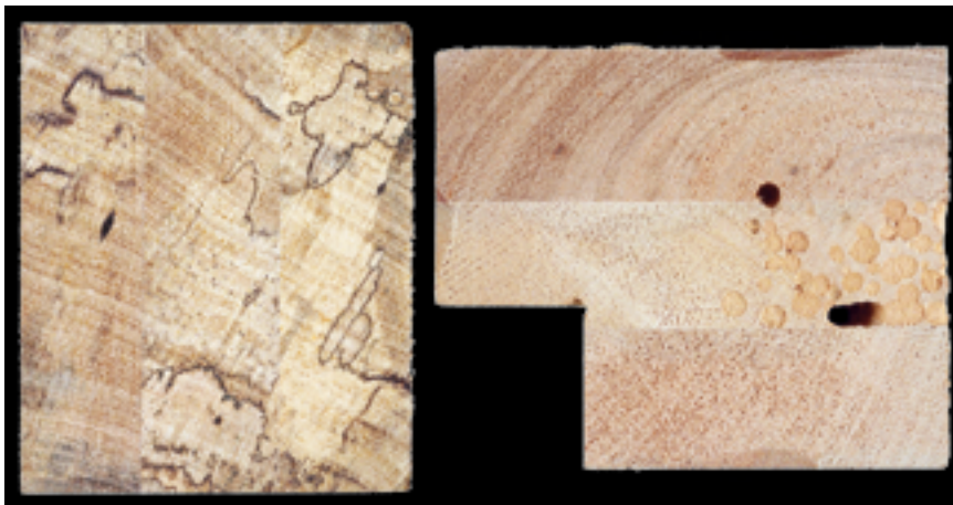
Abb. 2.2: Biologischer Holzabbau an dreilagig verklebten Fensterkanteln aus ungeeigneten Holzarten; links: intensiver Befall durch Weißfäule in einer Kante der Holzart White Meranti ( Shorea spp., subg. Anthoshorea ), rechts: Befall durch Insekten in einer Mittellage der Holzart Rubberwood ( Hevea brasiliensis )
