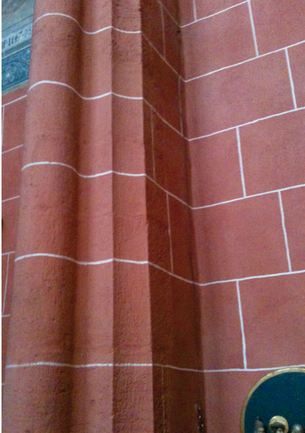
Bild 17 ■ Aufgemalte Lagerfugen als Scheinfugen
