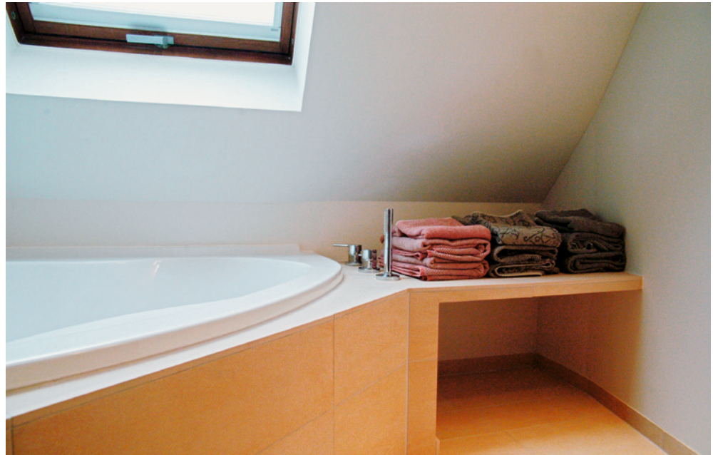
Abb. 1.23: Die Badewanne und Ablage werden neu verfliest. Unterhalb der Ablage entsteht so Stauraum.
