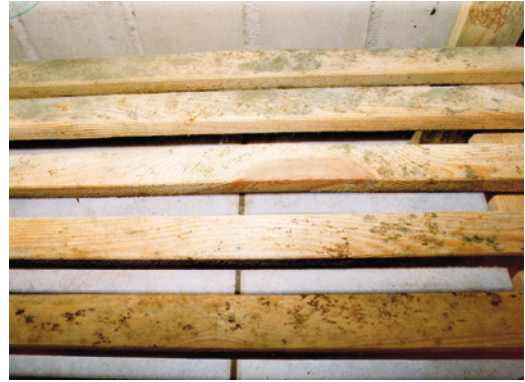
Abb. 1.6: Schimmelpilzbildung auf einem Kellerregal nach Feuchteinbruch
