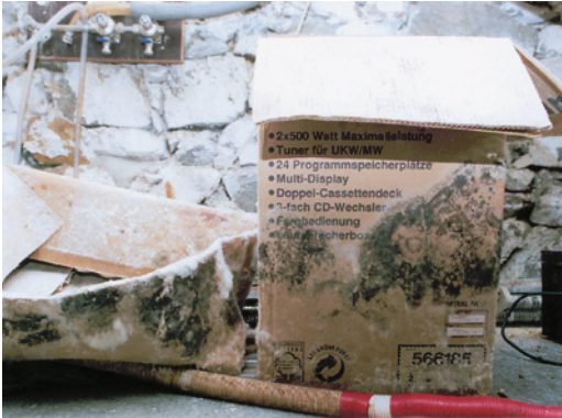
Abb. 1.9: Schimmelpilzbefall auf dem Inventar in einem feuchten Keller
