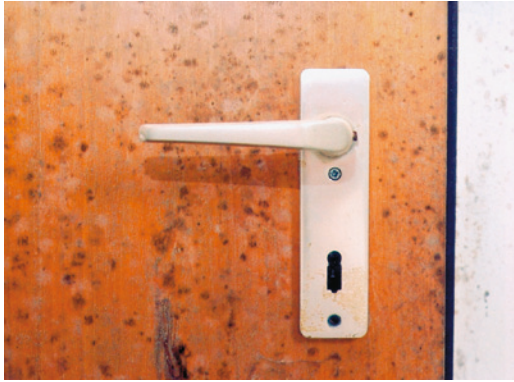
Abb. 1.5: Schimmelpilzbefall auf der Furnieroberfläche eines Türblatts in einem ungenutzten Kellerraum
