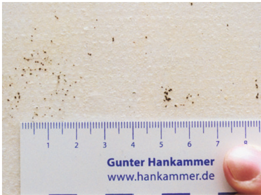
Abb. 1.7: Offen sichtbarer Schimmelpilzbefall auf einer Gewebetapete nach einem Wasserschaden
