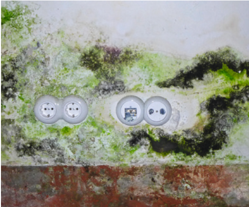
Abb. 1.25: Algenbildung und Schimmelpilzbefall an der Raumseite einer durchfeuchteten Außenwand im Souterrain. Die Oberfläche wurde tagsüber vom Sonnenlicht beleuchtet. Die Tages- und Nachtphasen zeichnen sich aufgrund des radialen Wachstums der Schimmelpilze durch helle und dunkle kreisförmige Zonen ab.
