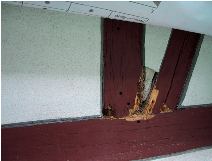
Bild 2-9 Da ein Schlagregenschutz nicht genehmigt wurde, trat wenige Jahre nach Sanierung der Fachwerkwände aufgrund erhöhter Schlagregenbelastung Schädlingsbefall auf.
