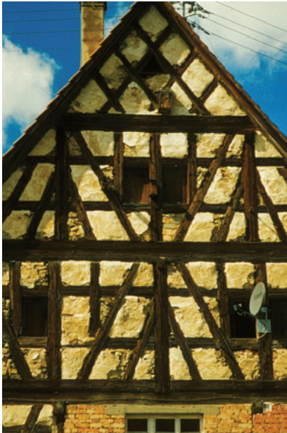
Bild 2-8 Altersbedingte Schäden durch fortschreitende Auflösung von Kalkputz und Lehmausfachung bei historischem Fachwerk
