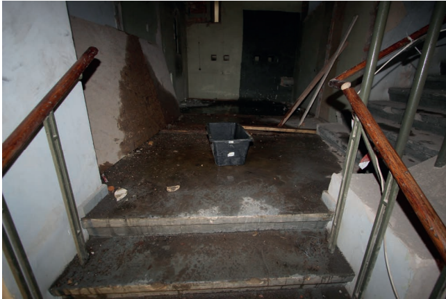
Bild 5: nasses Treppenhaus mit historischem Parkett
