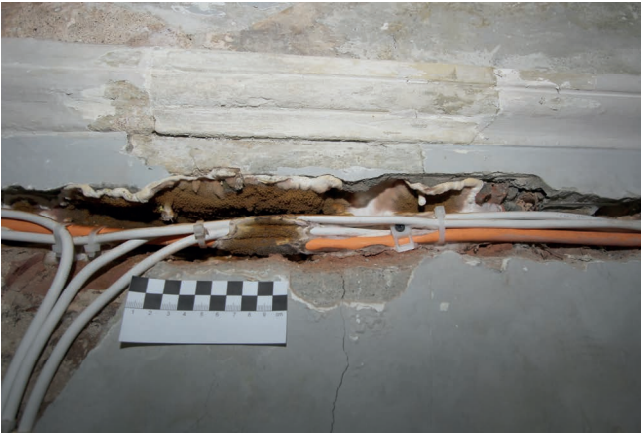
Bild 17: Ausbreitung des EHS im Kabelkanal
