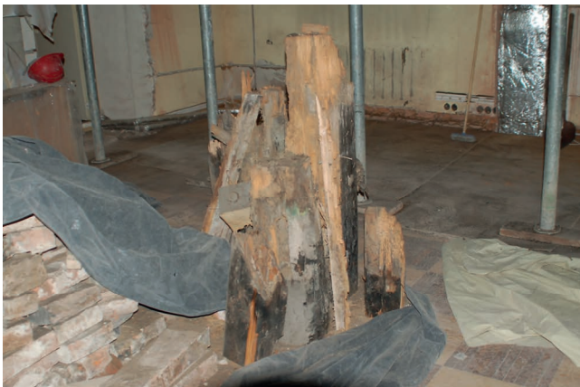
Bild 15: Befall am Holz
