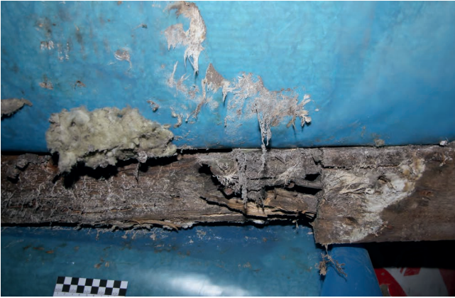
Bild 16: Befall in der Dachkonstruktion
