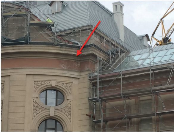
Bild 23: Nationalmuseum Begutachtung Wasserschäden
