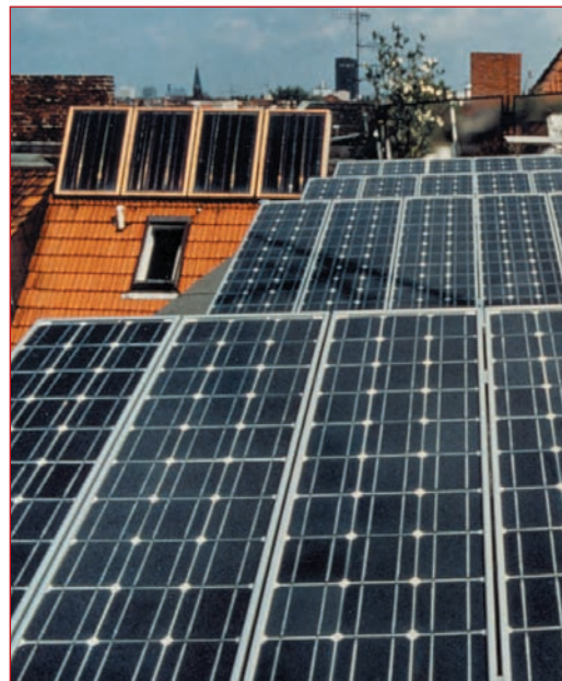
Abb. 1 – Auf den Dächern ist ja Platz genug: solarthermische Dachanlagen werden überwiegend zum Nachheizen des Wassers in Warmwasserspeichern des Zentralheizungs-Systems genutzt
