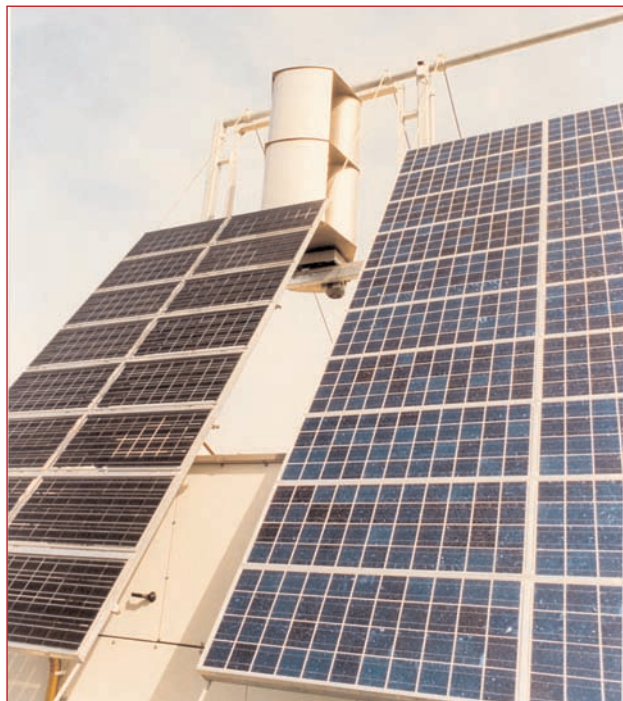
Abb. 78 – Ausführungsbeispiel einer Fotovoltaik-Anlage, kombiniert mit einem Savonius-Windgenerator (oben Mitte)
